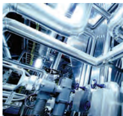
Entorno altamente corrosivo típico: planta central de servicios públicos
